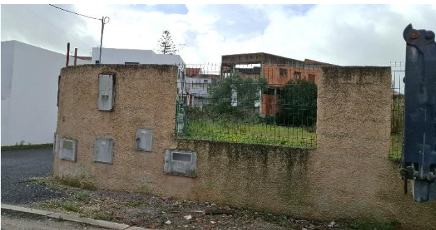
Foto 18: Construção inacabada e em avançado estado de degradação
