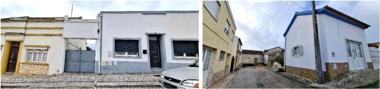
Fotos 94 e 95: Edifícios/construções em avançado estado de degradação junto a edifícios novos / reabilitados, com o respetivo impacte na envolvente
