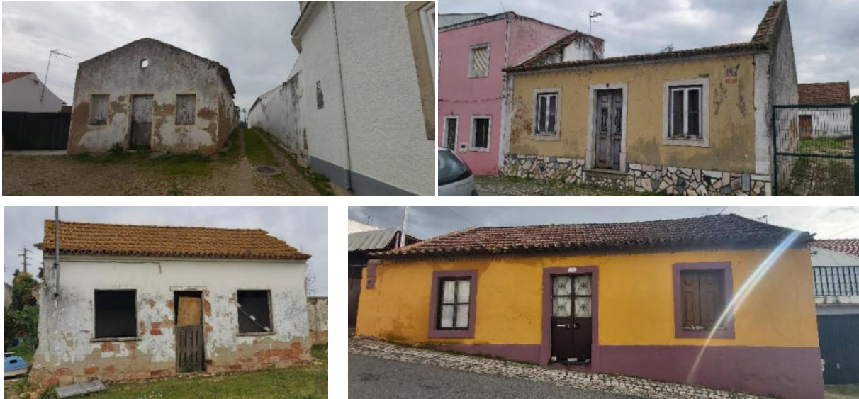
Fotos 28 a 31: Edifícios em avançado estado de degradação (b)
