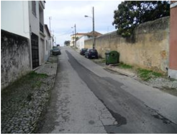
Figura 7 – Pavimento e passeio em mau estado de conservação na Rua da Boa Vista
