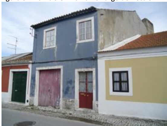
Figura 5 - Edifício em mau estado na Rua da Boa Vista
