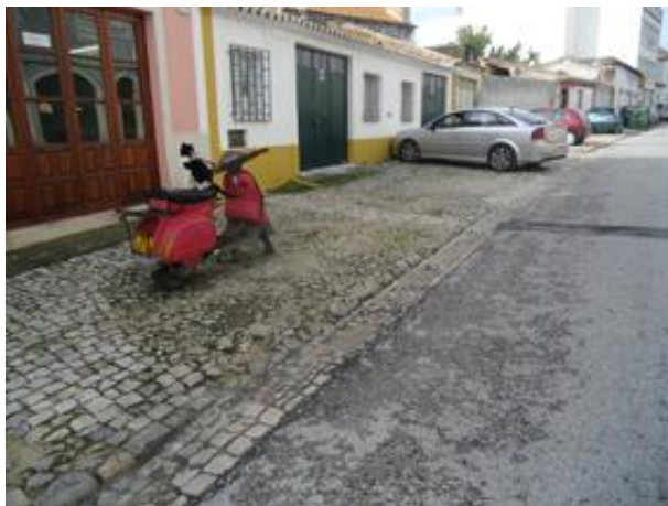
Figura 9 – Pavimento em calçada em mau estado de conservação na Rua José Ribeiro da Costa
