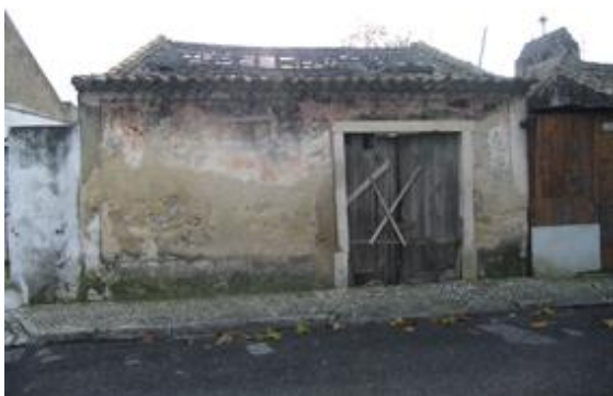
Figura 3 – Edifício em ruína no Largo do Rossio
