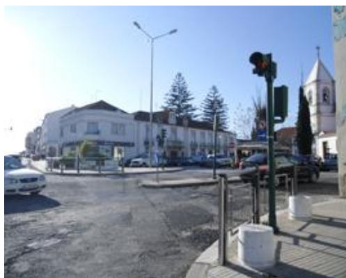
Figura 5 – Entrada para o Largo São João Batista, com pavimento em mau estado de conservação
