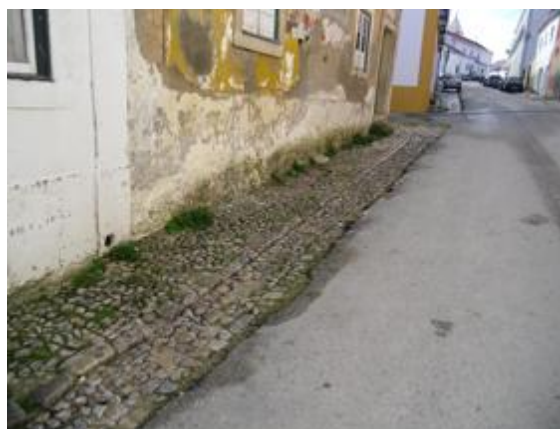
Figura 8 – Rua de S. Sebastião com passeio indefinido e em mau estado
