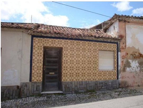
Figura 3 – Edifício com revestimento dissonante na Travessa da República
