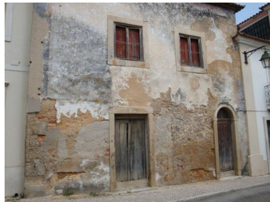
Figura 2 - Edifício devoluto, cobertura em ruína na Rua Mouzinho de Albuquerque
