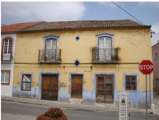
Figura 1 - Edifício em mau estado na Rua Mouzinho de Albuquerque
