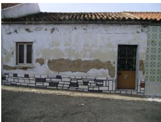
Figura 5 - Edifício em mau estado de conservação no Beco das Ferreas
