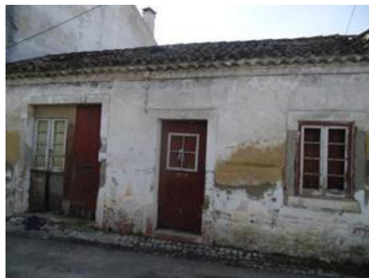
Figura 2 - Edifício devoluto na Rua José Maria Nicolau
