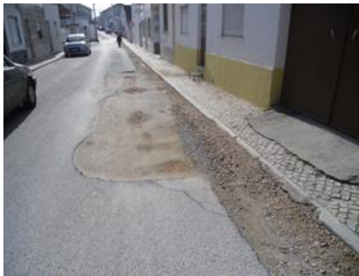
Figura 9 – Estrada com pavimento em mau estado de conservação Rua do Açude
