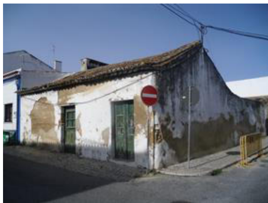
Figura 1 - Edifício devoluto na Rua José Maria Nicolau
