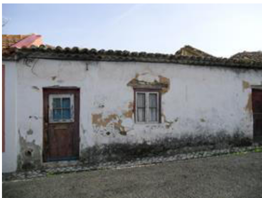
Figura 3 - Edifício com cobertura em ruína no Beco das Ferreas
