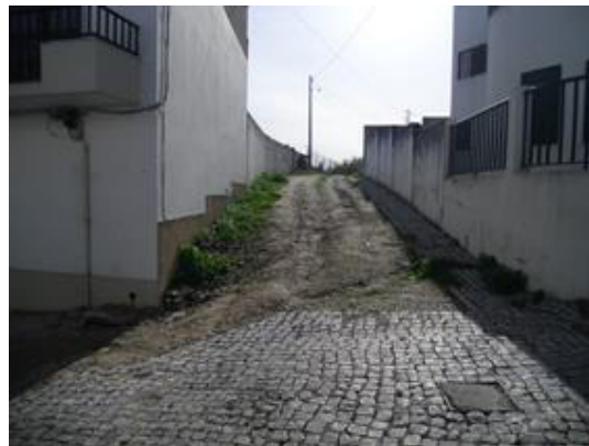
Figura 10 – Rua sem pavimentação
